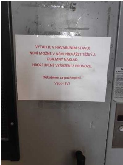
Oznámení na výtahu
